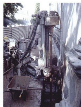
Fig. 4 - Execução de microestacas - lintel exterior à fachada lateral - fase de furacão em profundidade
