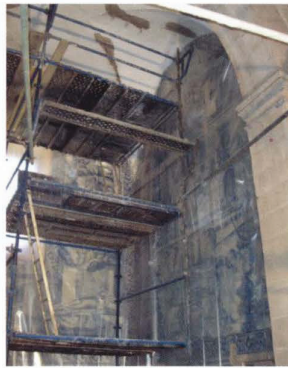
Fig. 8 - Protecção prévia de painel azulejar, para posterior consolidação e reforço de tectos e pilastras
