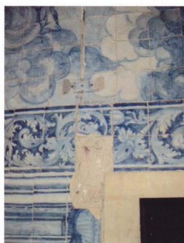
Fig. 3 - Controlo de abertura de fenda estrutural parede interior, revestida com painel azulejar
