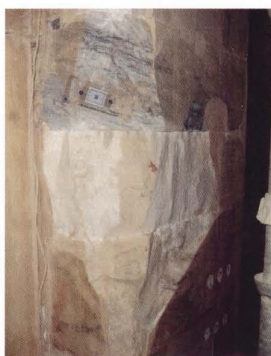
Fig. 2 - Controlo de abertura de fracturas geradas pela delaminação do revestimento das pilastras
